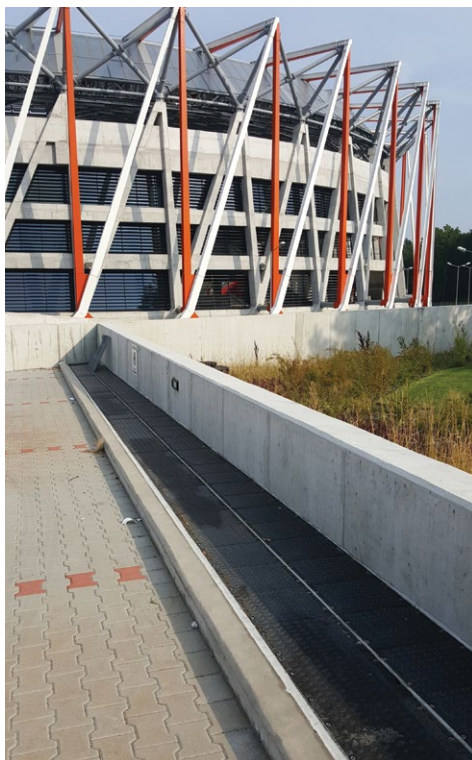
Stadion Miejski Białystok Kanały instalacyjne AS-300 z pokrywą żeliwną
