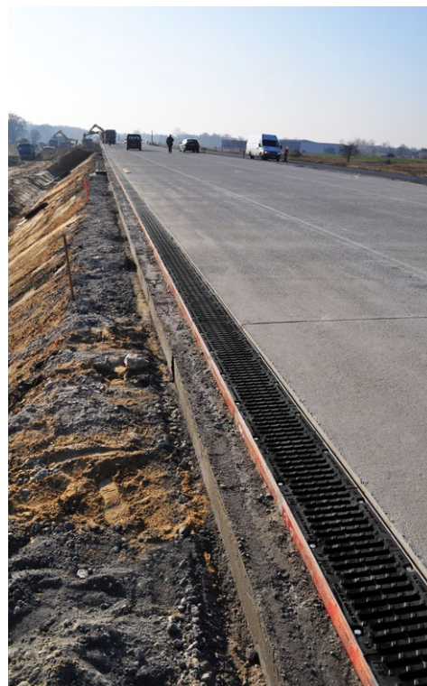
Droga Ekspresowa S8 Zawada AS-200 - 900mb
