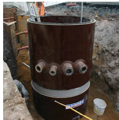
Studnia specjalna z przyłączami przewodów ciśnieniowych w kręgu kamionkowym.
